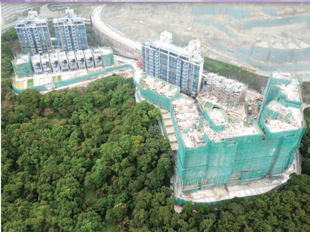
位於新界沙田九肚第56A區沙田市地段第578號之豪華住宅發展項目一上蓋建築工程進行中
